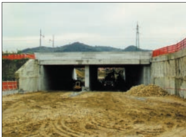
Il sottopasso ferroviario che collegherà il quartiere Meridiana con Via Piave e Via Brigate Bolero.
